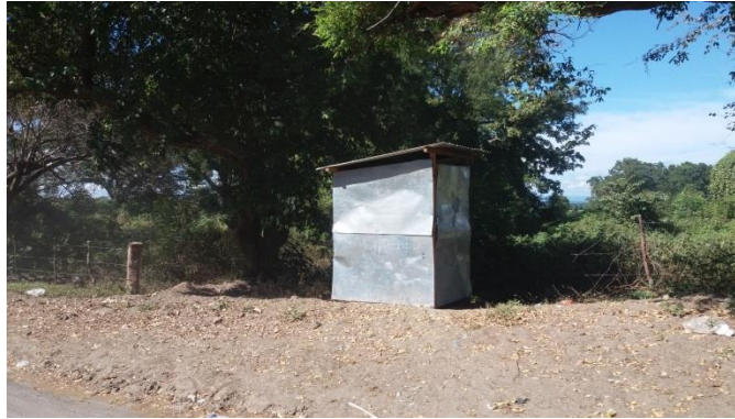
Afectación 3: Letrina con paredes y techo de zinc.
